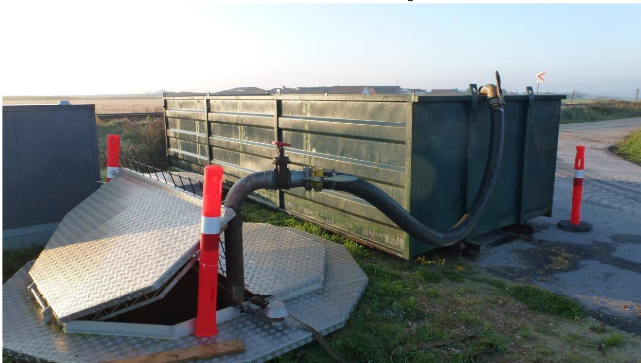
Hovedpumpestation og opstillet container
